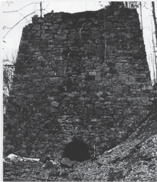
Haut fourneau en ruine des Forges Grondin. (Collection Corporation pour le patrimoine sidérurgique de la Mauricie)
